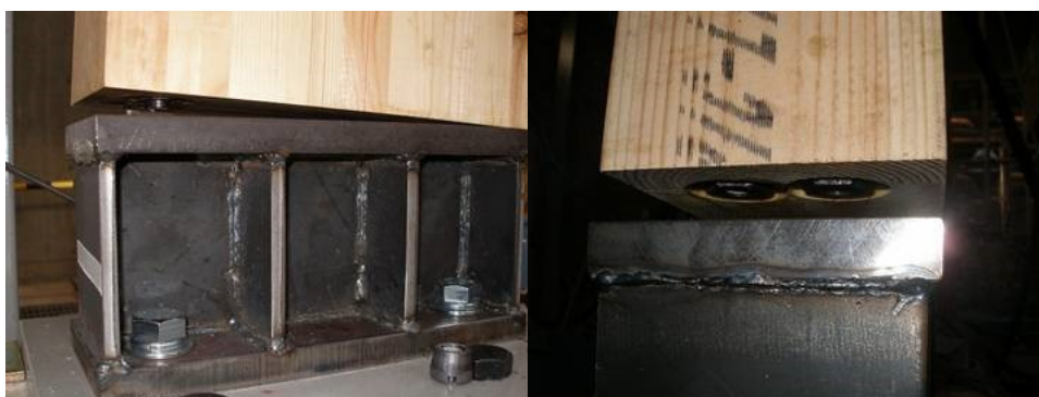
Photo2-2 柱脚の破壊状況 (LSB の破断)
