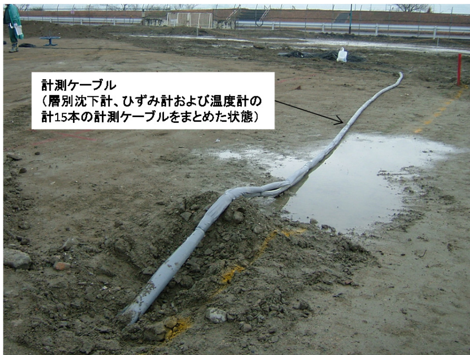
図-5.5.5 計測ケーブルの配線状況
