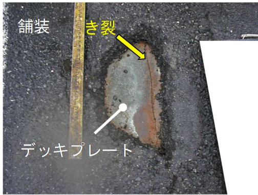
(a) Tyep1 デッキ進展型き裂
