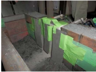
写真-6.3 圧力計、配線の養生
