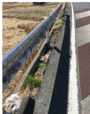
b. 擁壁背面の沈下
