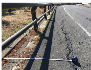
a. 舗装面のひび割れ
