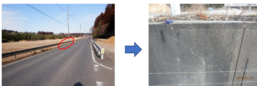
a. 千葉県，市道，左の写真で赤枠はひび割れの位置，右の写真は擁壁前面
