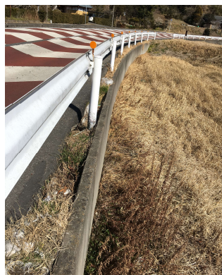
a. 裏込め土の流失
