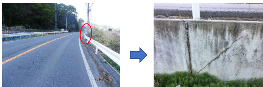
b. 長野県，国道，左の写真で赤枠はひび割れの位置，右の写真は擁壁前面
