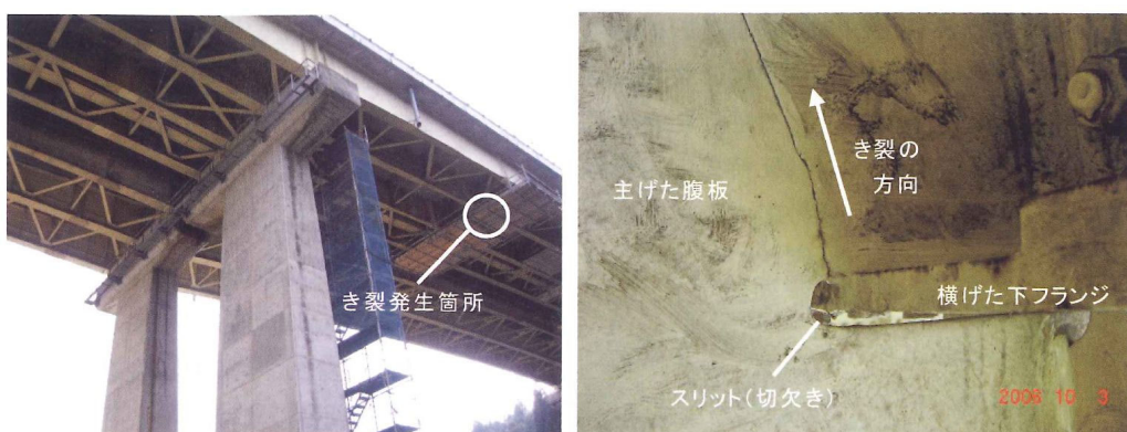
(a)き裂発生箇所
