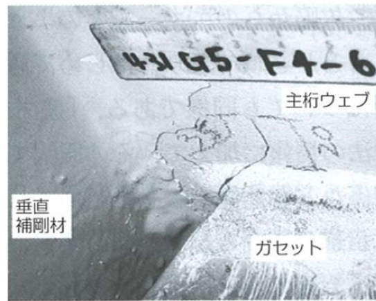
(b) 重度な損傷
