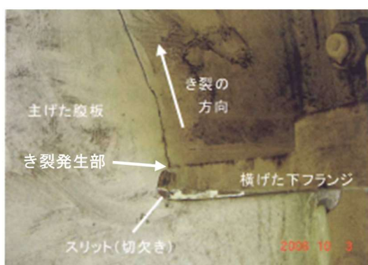
(a) 主桁取り付け部からの疲労損傷 1-2)
