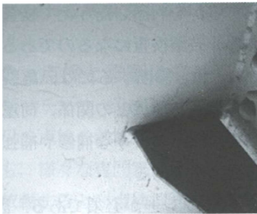
(a) 軽度な損傷
