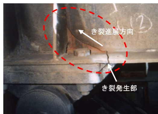
(b) ソールプレートからの疲労損傷 1-3)
